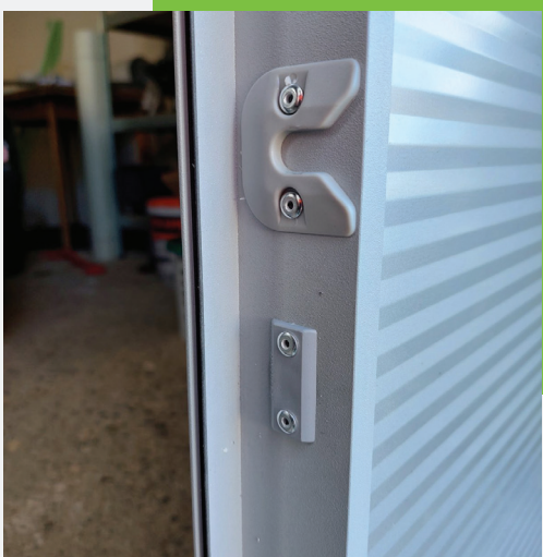
Vgrajeno elektromagnetno stikalo.
